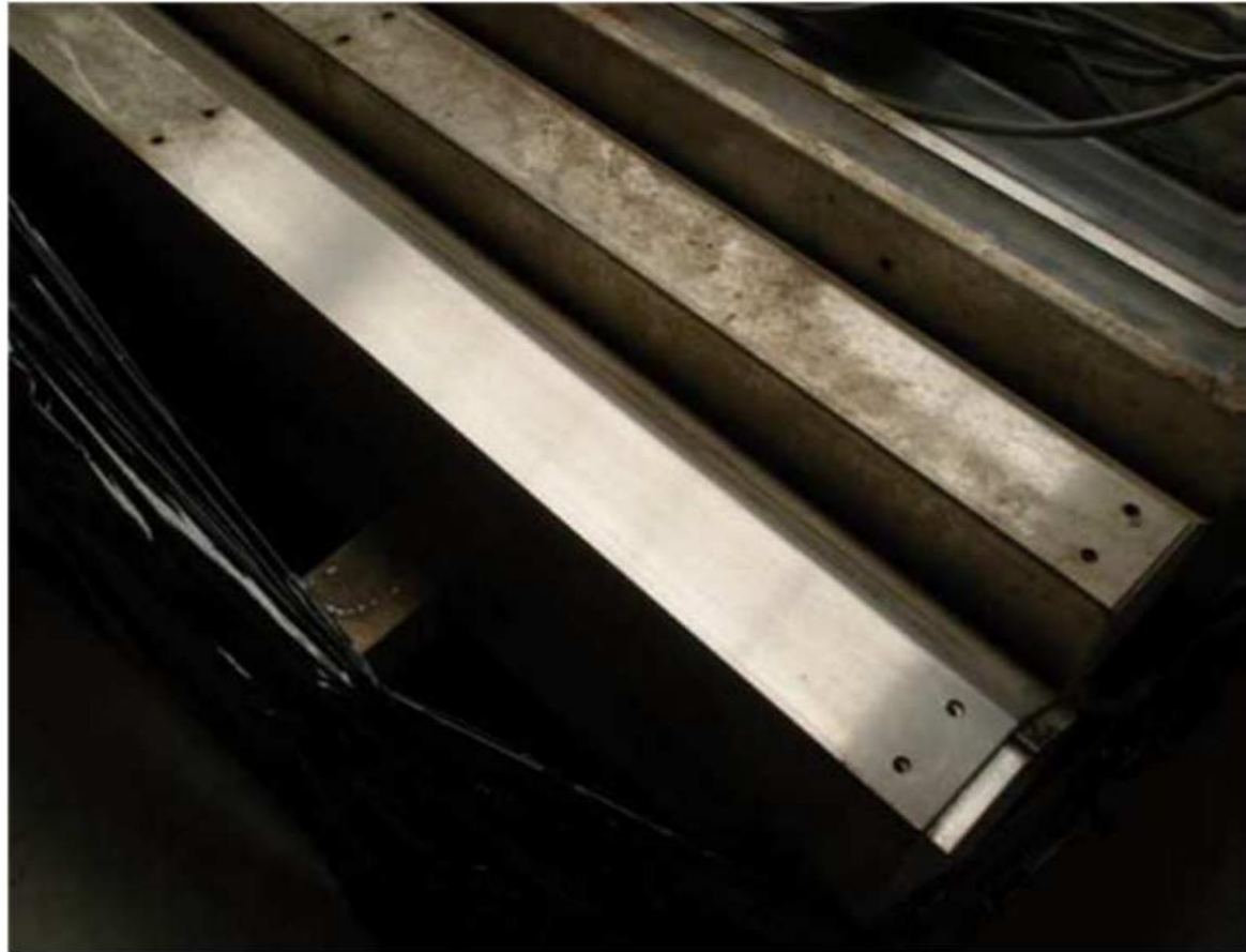
Fig. 4. Luminaires en inox 316L corrodés (la réglette du bas a été partiellement traitée)
